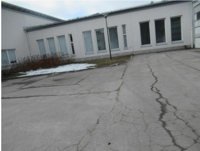
Kuva 3.1.1: Asfalttipäällysteen halkeamia ja reunakivien irtoamista. Asfaltti- ja betonipäällysteiden osittaisiin kunnostuksiin on aiheellista varautua tarkastelujakson alkupuolella.
