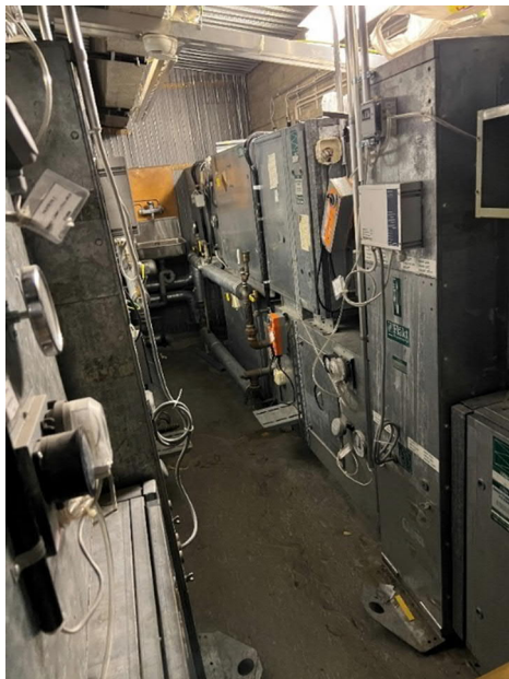
Kuva 4.3.1: B-osan ilmanvaihtokoneet TK2 ja TK3.
