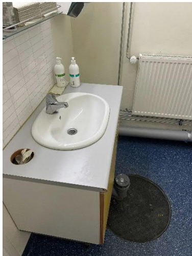
Kuva 4.2.1: Vesi ja viemäriasennuksia opettajanhuoneen sosiaalitulassa, joka sijaitsee väestönsuojassa
